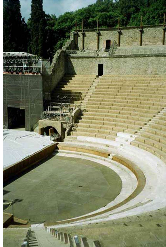
Obr. 10: Pohľad na rekonštrukčné práce v hľadisku aj javisku v júni 2010 (Autor: Rick Bauer, Zdroj: PompeiiInPictures 2024).
